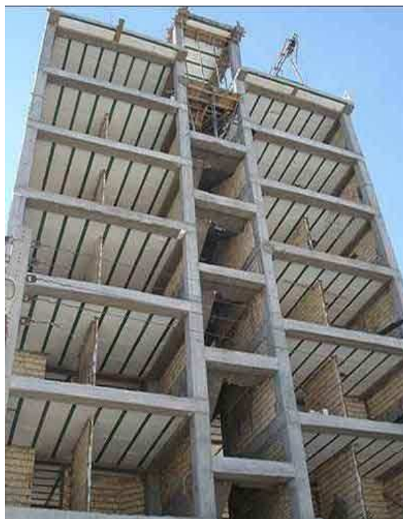
ایجاد ستون کوتاه به علت اختلاف تراز
