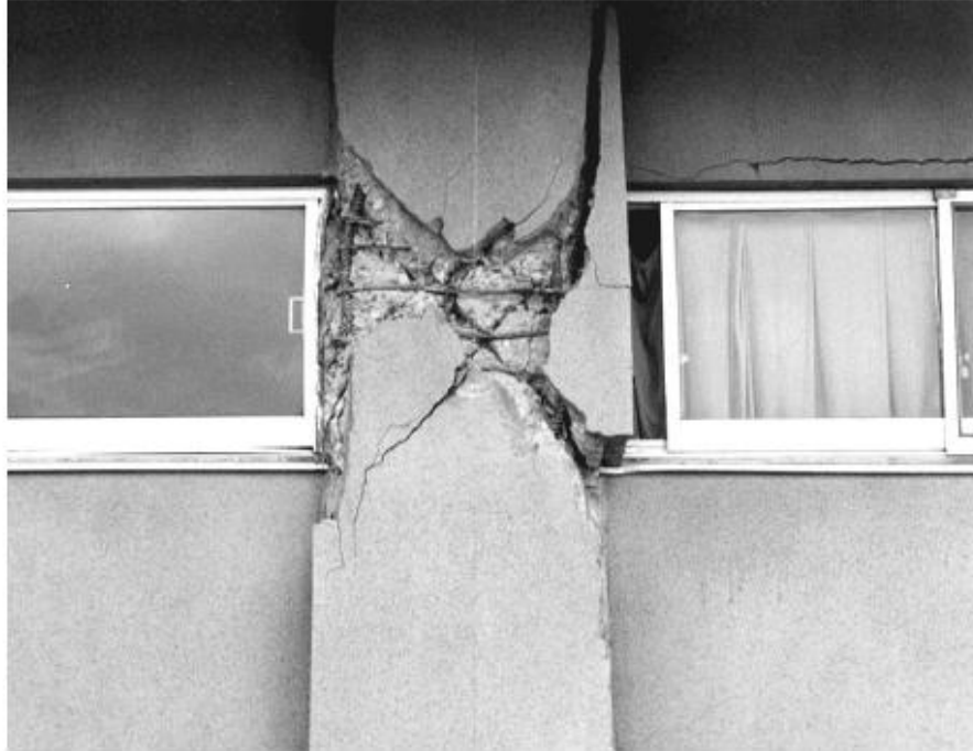
تخریب ستون کوتاه در زلزله ۱۹۷۸ میاگی، ژاپن
